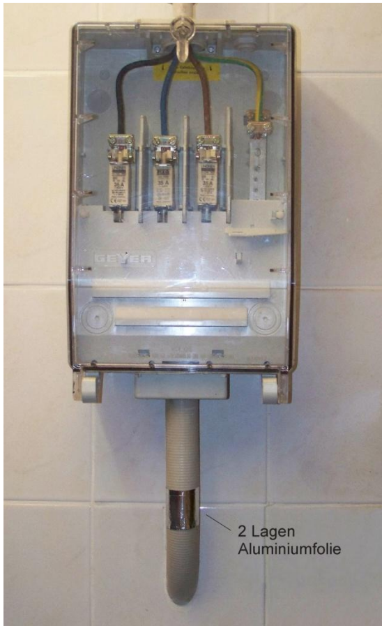
Bild 5: Die Übertragung von Hyperschallschwingungen aus dem Stromnetz in die Hausinstallation lässt sich durch Umwickeln der Zuleitung mit Aluminiumfolie verhindern.
